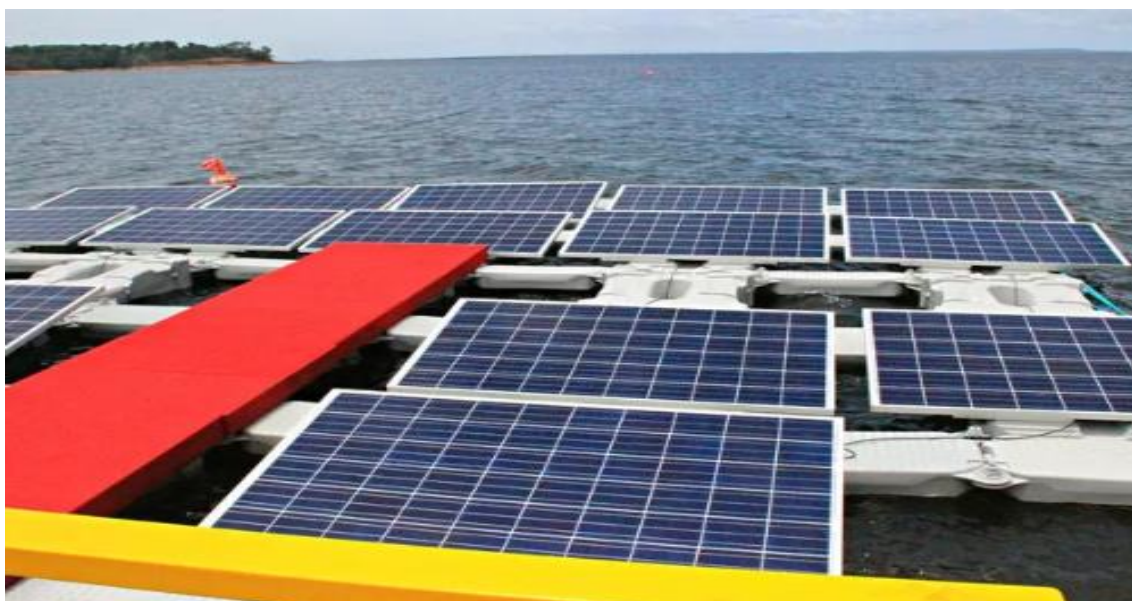
Figura 46 - Placas Solares Flutuantes Sobre o Rio
